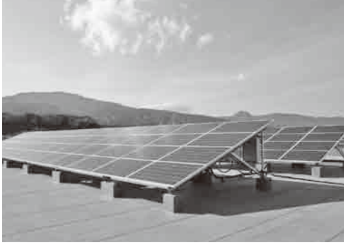
▲ 現在、小学校に設置されている太陽光発電設備
